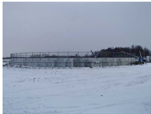
写真 : 肥培施設 (スラリータンク) (平成30年12月撮影)
