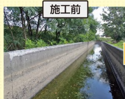
凍害、摩耗で老朽化した コンクリート用水路の表面
