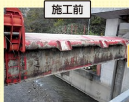
塗装が劣化した頭首工ゲート
