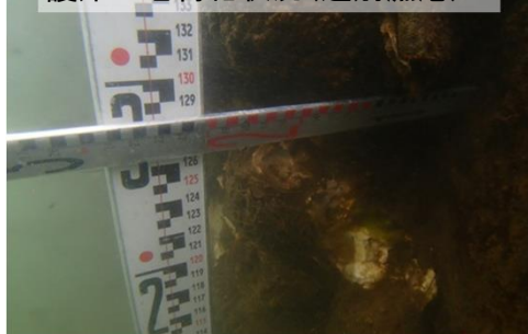
護岸の老朽化状況(遠別漁港)
