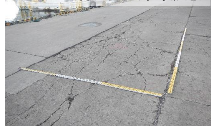
道路の老朽化状況(砂原漁港)
