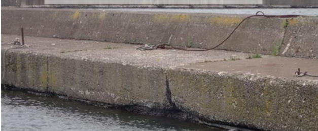
防波堤の老朽化状況(東浦漁港)
