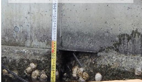
岸壁の老朽化状況(古平漁港)
