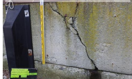
岸壁の老朽化状況(寿都漁港)
