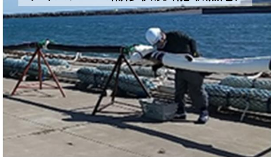
アイスブーム補修状況(能取漁港)
