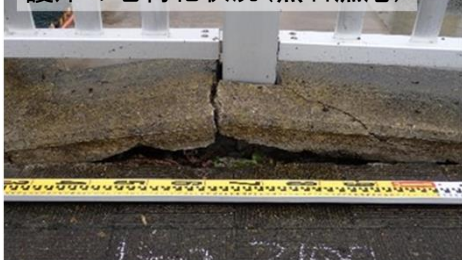
護岸の老朽化状況(熊石漁港)
