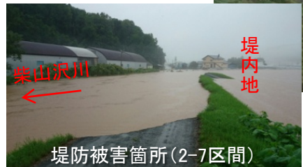
堤防損傷箇所 （KP22.6左岸）
