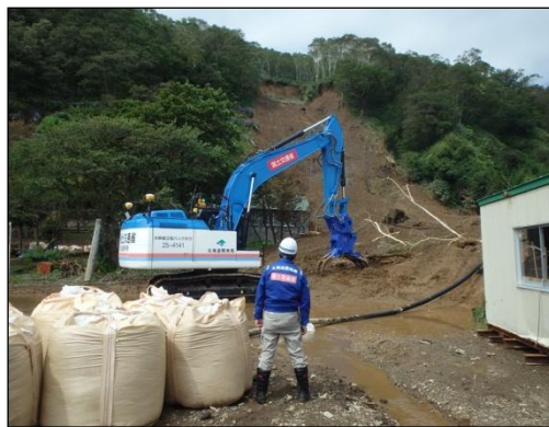
羅臼町崩落現場（H28. 8. 27）
