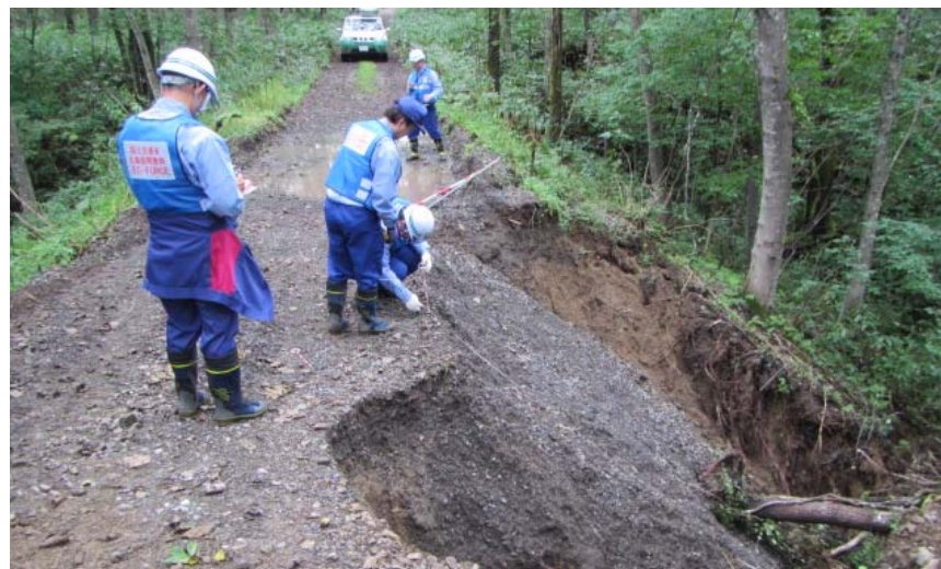
札幌開建道路班 清水町 羽帯南9線被災箇所調査
