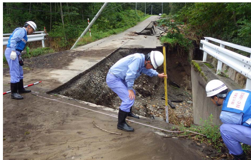
関東地整道路班 清水町 被災箇所調査
