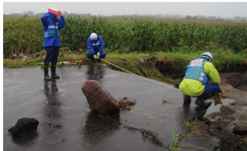
札幌開建道路班 清水町 石山9線被災状況調査
