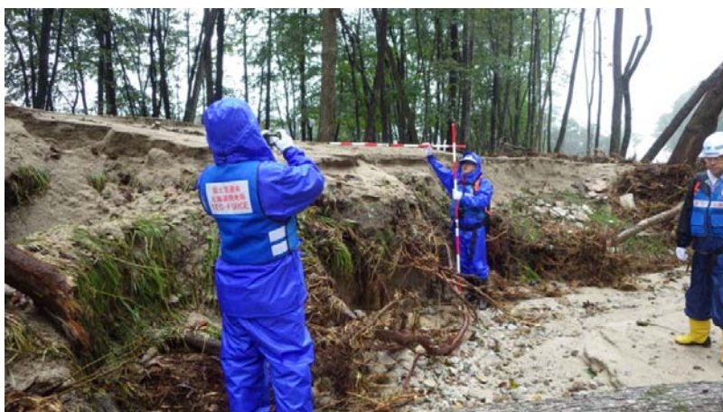
留萌開建河川班 清水町 ヌプチミップ川被災状況調査
