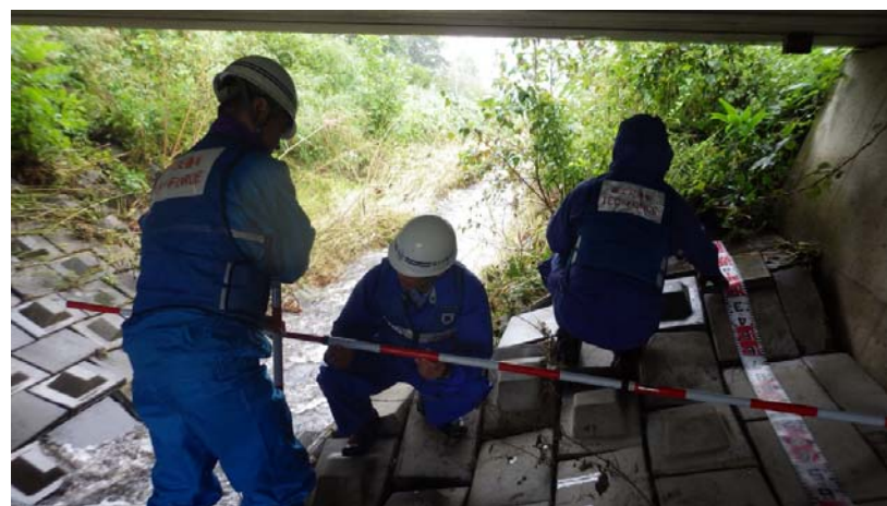
関東地整道路班 清水町 中央11号橋被災状況調査
