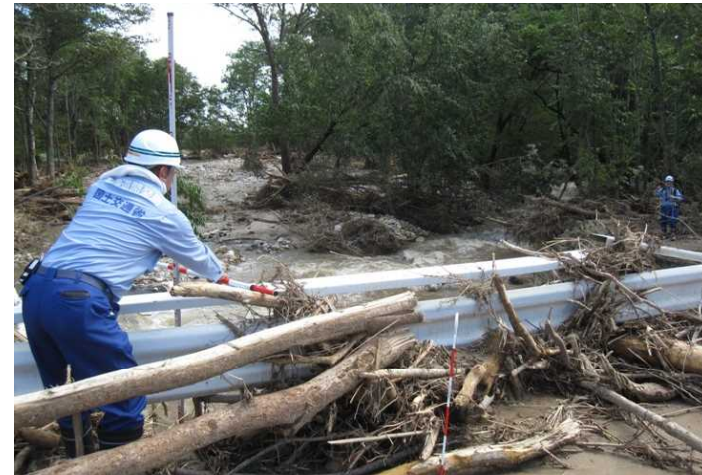
小樽・函館河川班 清水町 小林川被災状況調査
