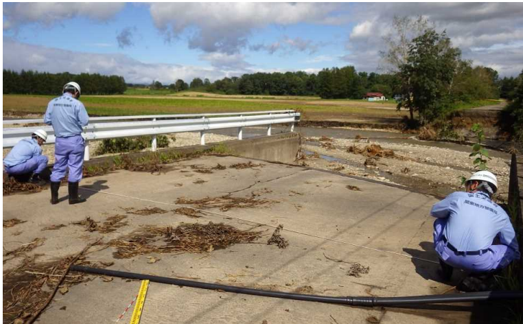
関東地整道路班 清水町 旭橋被災状況調査
