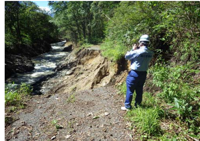
留萌道路班 清水町 町道400番 被災状況調査
