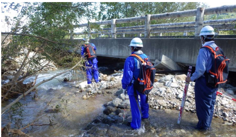
留萌河川班 清水町 造林川 丸山橋 被災状況調査
