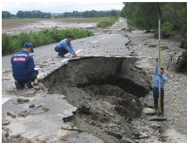
網走開建道路班 清水町 旭山地区道路崩壊箇所調査状況
