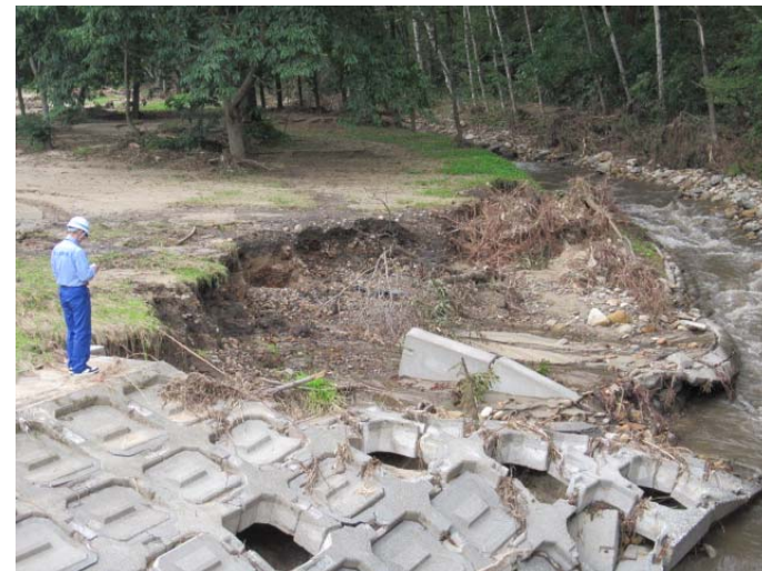
札幌開建道路班 清水町 清水羽帯間道路の調査状況（上・下）
