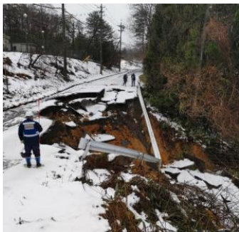
道路被害状況の調査
