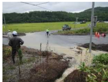
用水路の漏水状況
