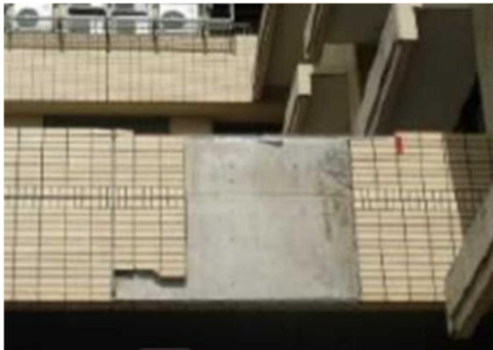
タイル落下による事故発生のおそれがあり、外壁改修が必要（整備前の状況）
