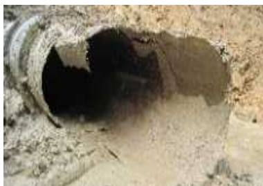
用水路の破損状況
