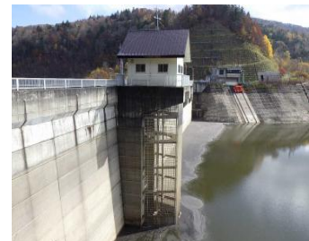
耐震化が必要な取水塔
