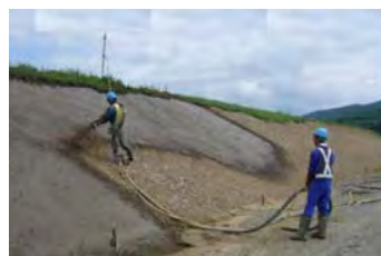
旭川市浄水場から発生する浄水汚泥(2,000m 3 /年)とリン等栄養分が豊富な地元家畜農家からの糞尿堆肥を混合し、法面植生基材へ有効利用。
