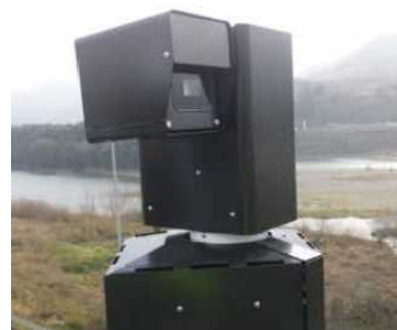
CCTVカメラの設置例
