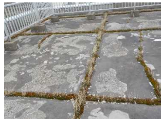
防水層の劣化
