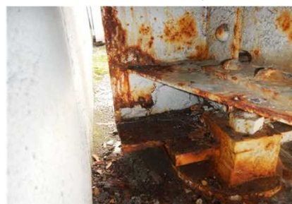
主桁・支承の腐食状況
