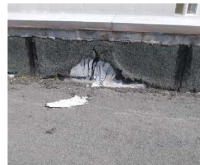
防水層の剥落
