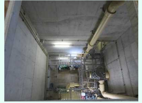
岩内海洋深層水取水施設
