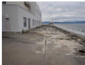
防水層の劣化
