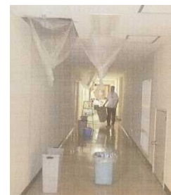
天井からの漏水
