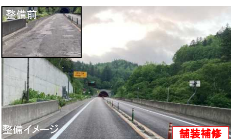
〈道路インフラの老朽化対策〉
