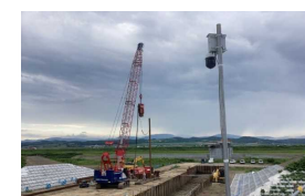
現場に設置したWEBカメラ
