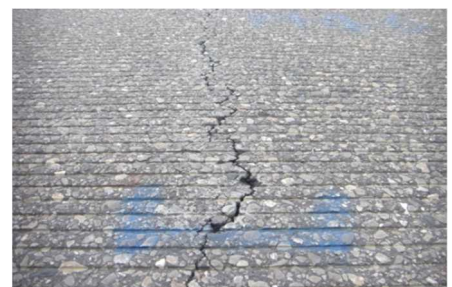
誘導路舗装の劣化状況
