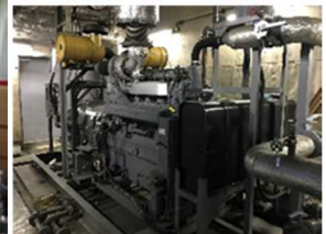
非常用電源装置のイメージ
