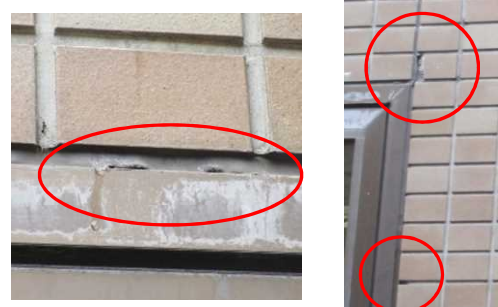
※外壁劣化イメージ
