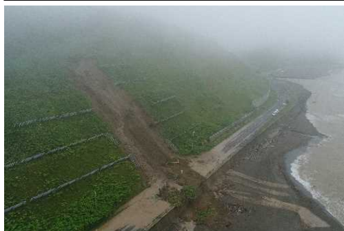
▲法面崩落被災箇所（写真①）
