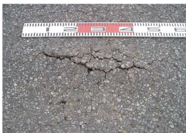
舗装の損傷（クラック）
