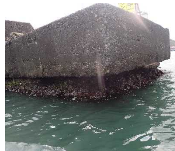
防波堤の老朽化状況 (苫前漁港)
