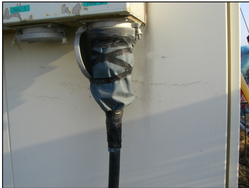
船舶給電施設の壁にゴミ付着の津波痕跡（地盤から 1.0m程度）
