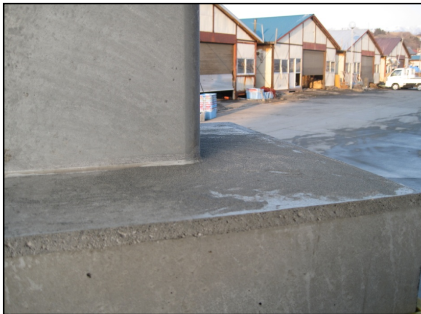
屋根付き岸壁の高さの約半分まで浸水（地盤から1.5m程度） 砂の付着の津波痕跡
