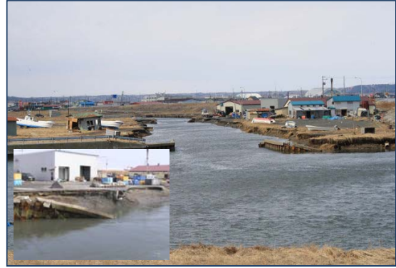
霧多布港(矢板護岸工の被災状況)
