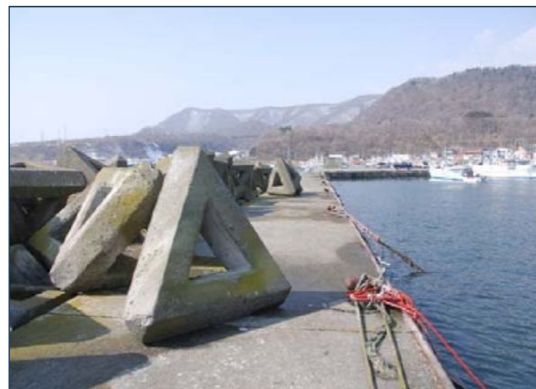
庶野漁港(消波ブロック散乱状況)
