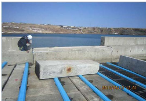
落石漁港(護岸上部工の被災状況)
