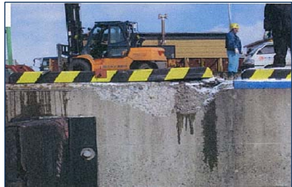
釧路港 (西港区第4埠頭岸壁上部コンクリート欠損)
