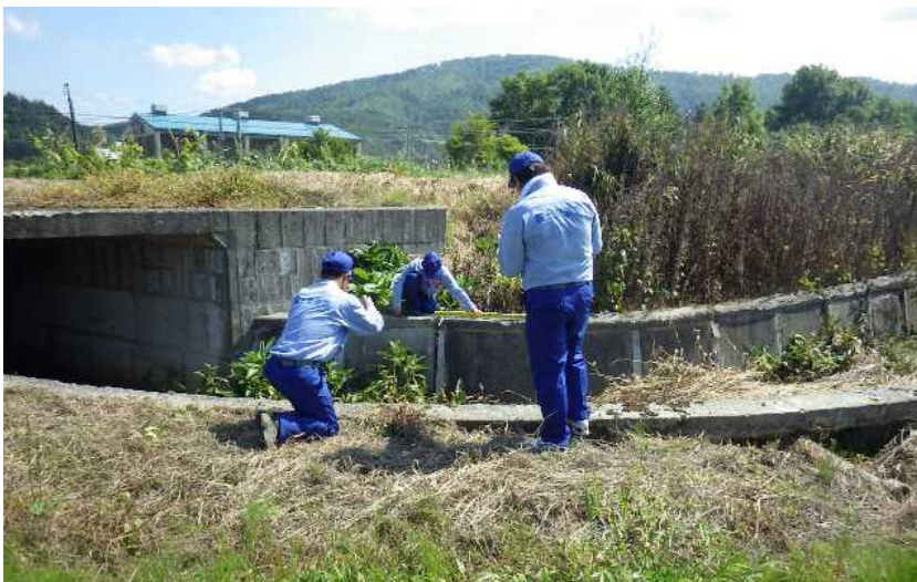
函館・小樽開建 南富良野町 被災箇所調査
