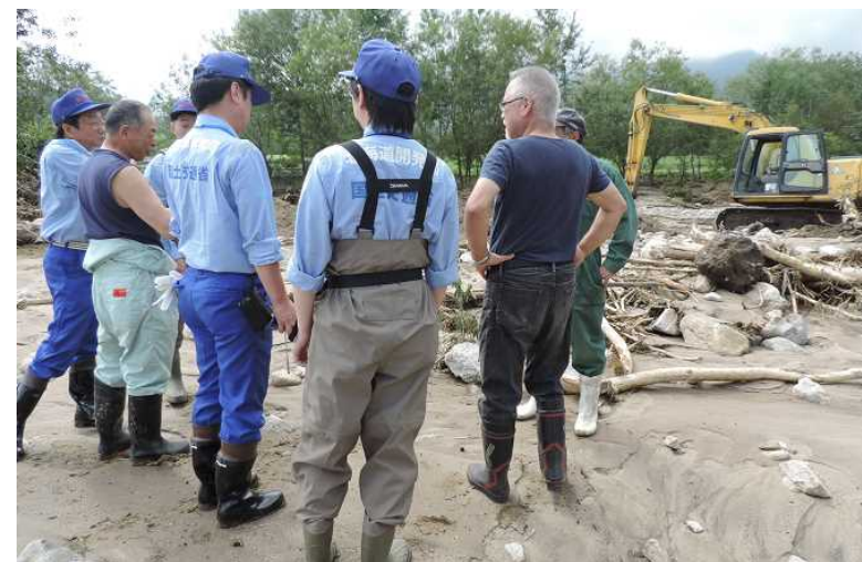
網走開建 清水町造林沢川上流 被災箇所調査
