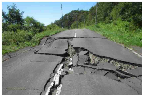
写真 2-10 安平町早来地区の道路被害
