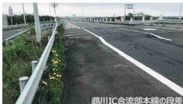
写真 2-9 鶴川 IC における道路被害状況
