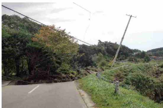
写真 2-11 厚真町幌里地区の道路被害
