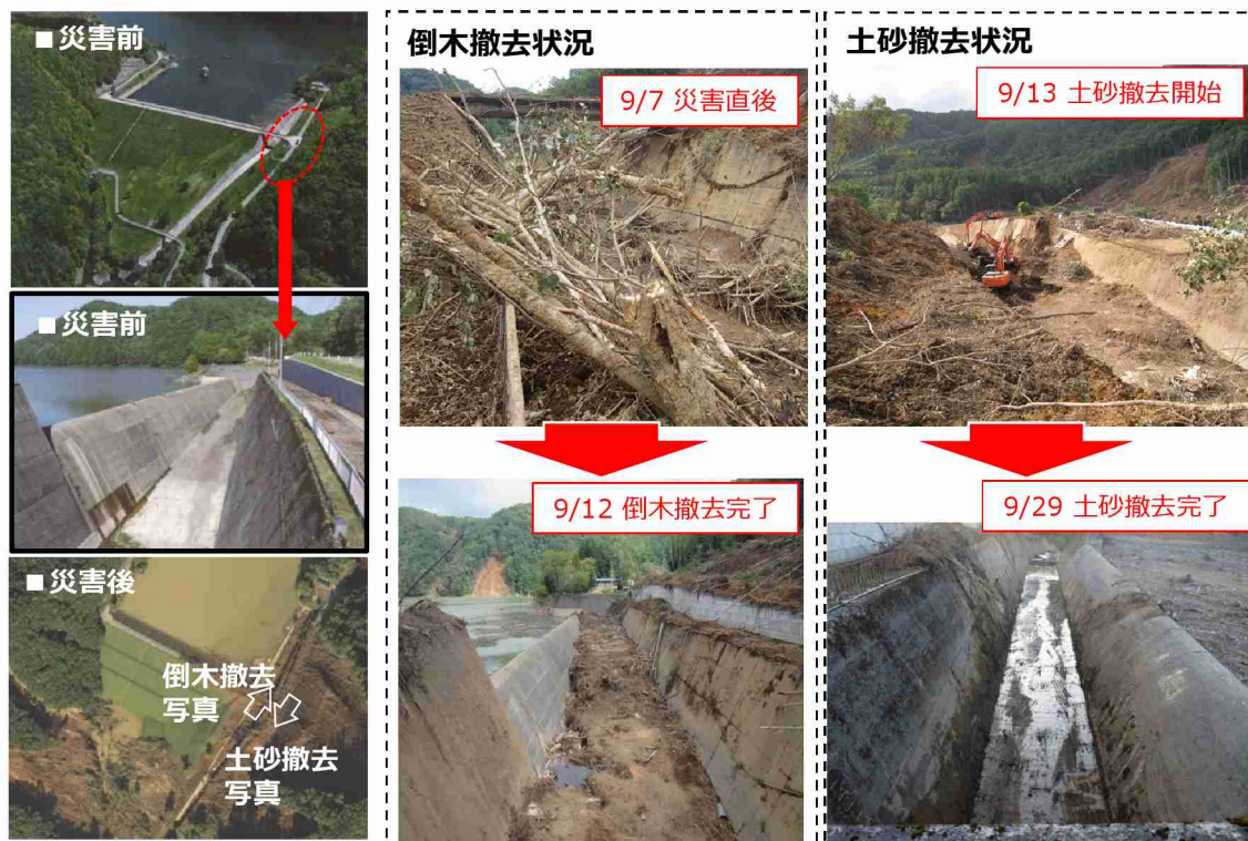
図 3-3 応急復旧作業前後の厚真ダムの様子
