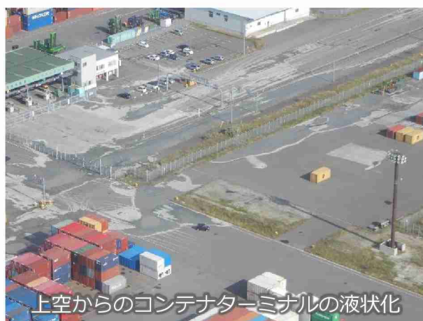
写真 2-17 苫小牧港における港湾被害の様子
