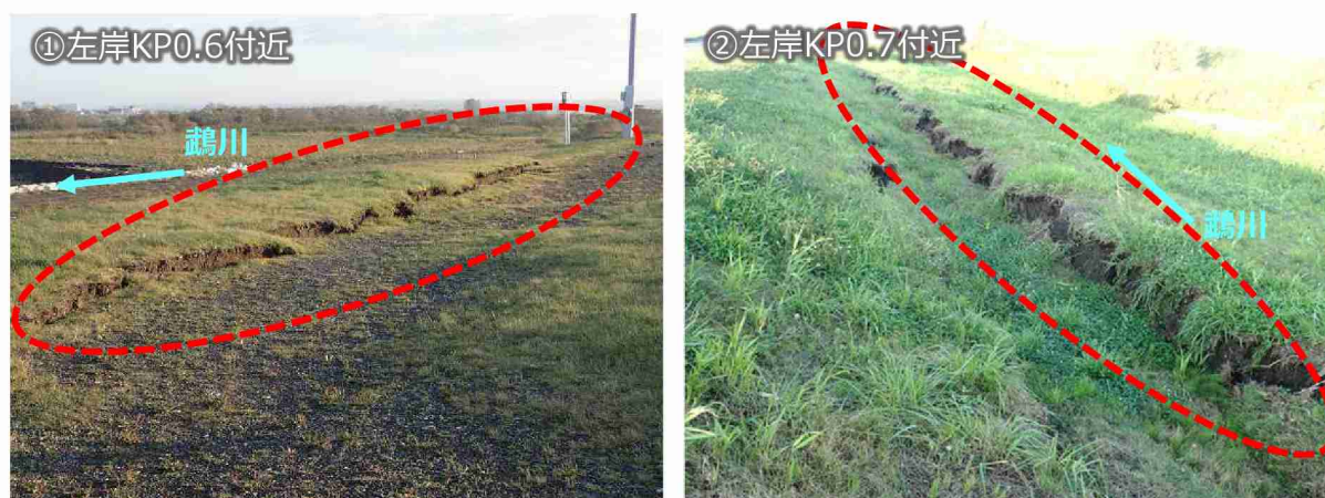
写真 2-6 鵒川での被害の様子
