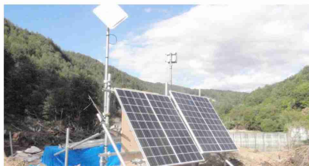
写真 4-24 監視カメラの設置
