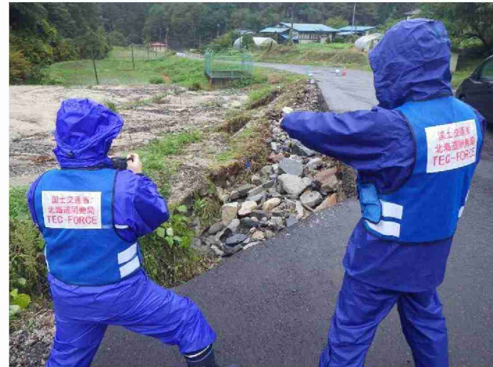
被災状況調査(河川被災箇所) (福島県伊達市・小石田川)
