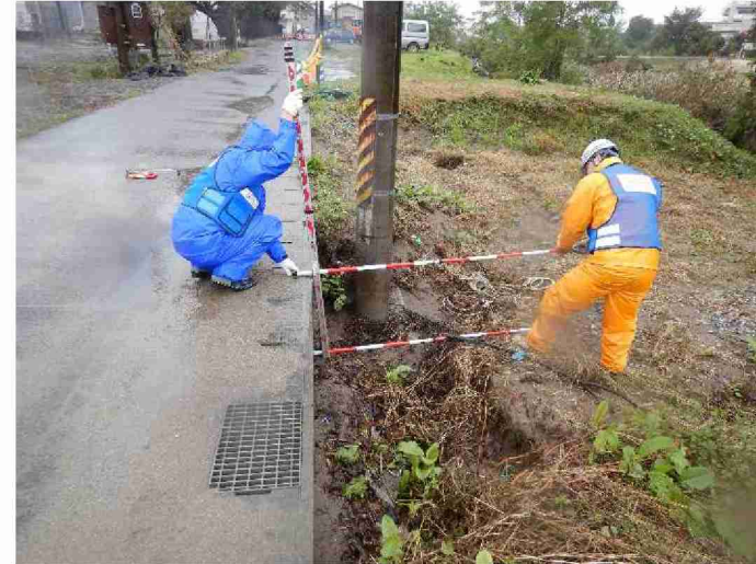
被災状況調査(河川被災箇所) (福島県郡山市・徳定川)
