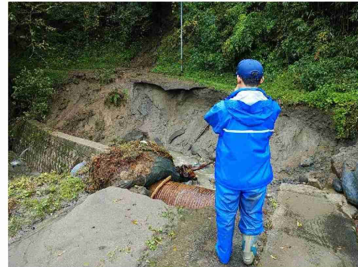
被災状況調査(道路被災箇所) (宮城県丸森町大張川張)
