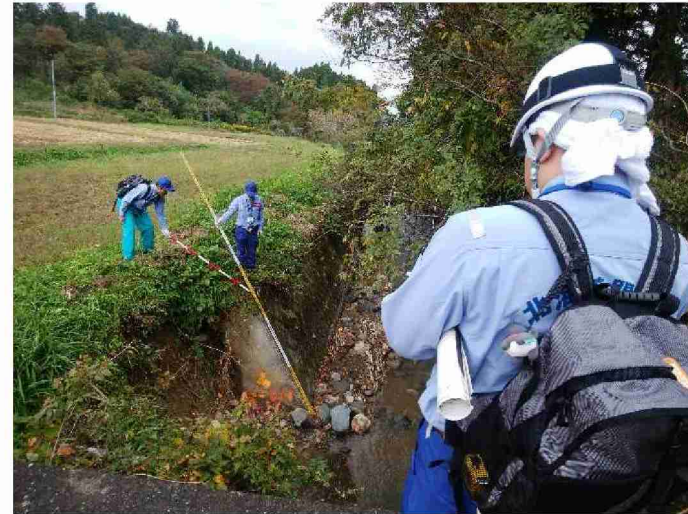
被災状況調査 (宮城県丸森町)
