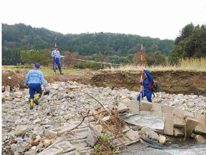
被災状況調査(河川被災箇所) (宮城県丸森町・鬼ヶ棚川)
