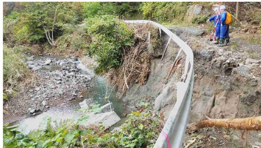
被災状況調査(河川被災箇所) (宮城県丸森町・五福谷川)
