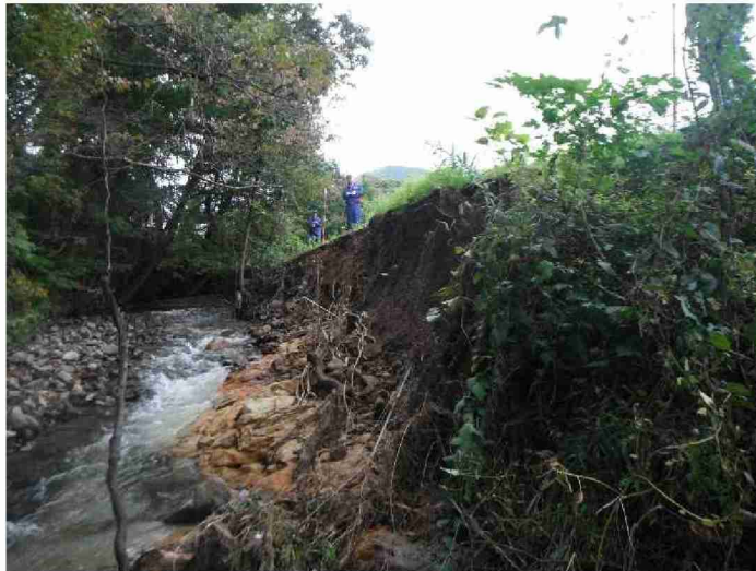
被災状況調査(河川被災箇所) (福島県郡山市・川底川)
