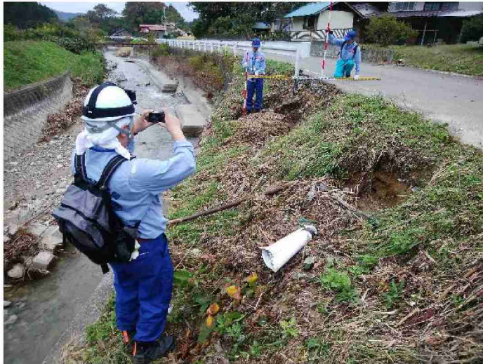
被災状況調査 (宮城県丸森町)
