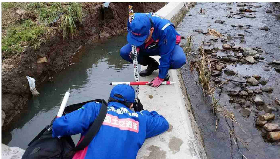
被災状況調査 (宮城県丸森町)
