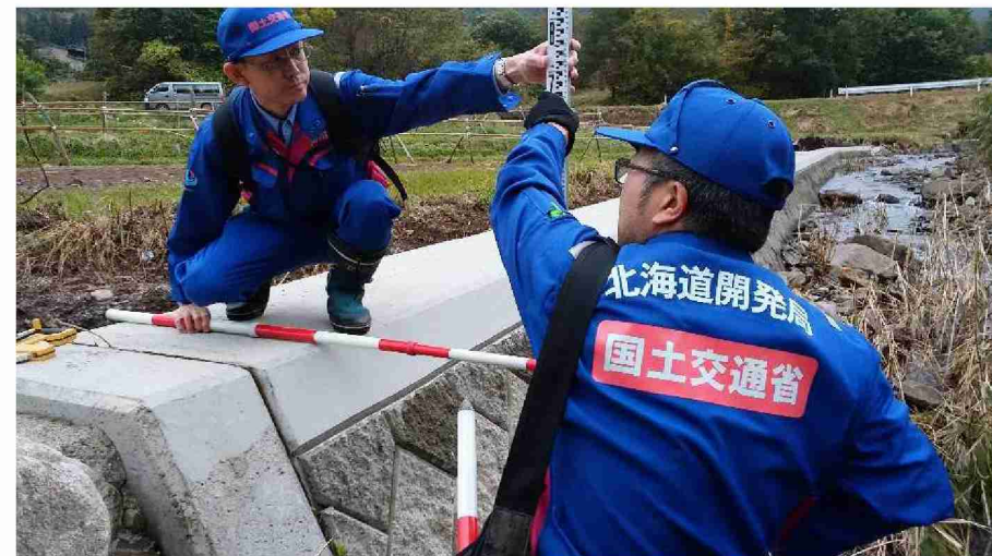
被災状況調査 (宮城県丸森町)
