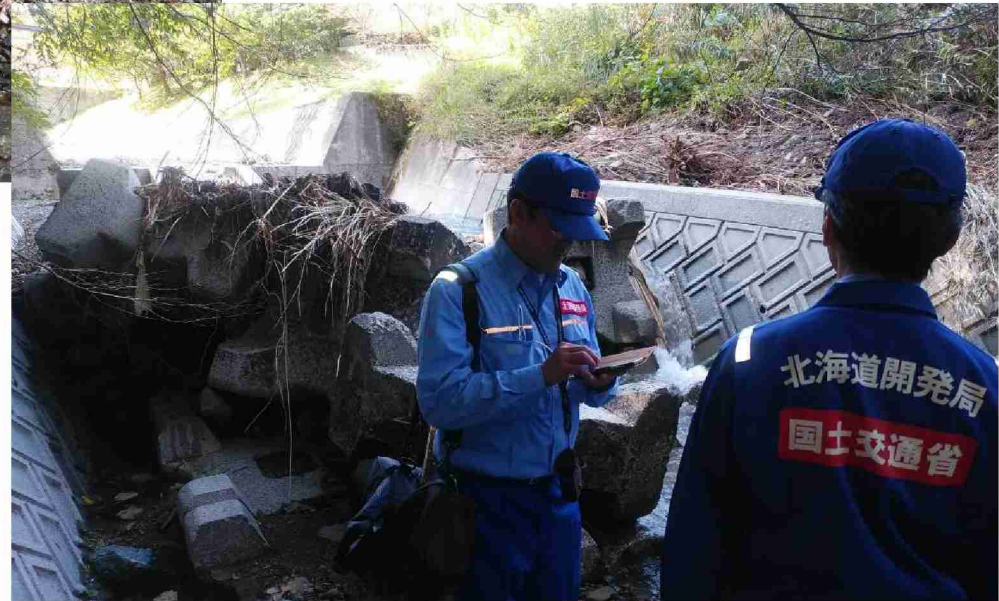
被災状況調査 (福島県相馬市)
