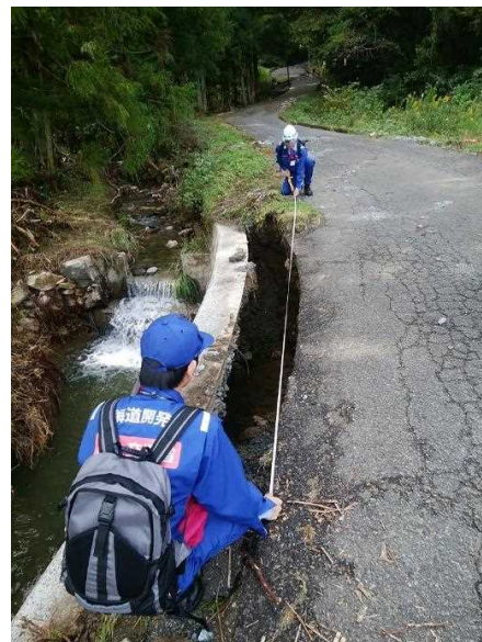
被災状況調査
