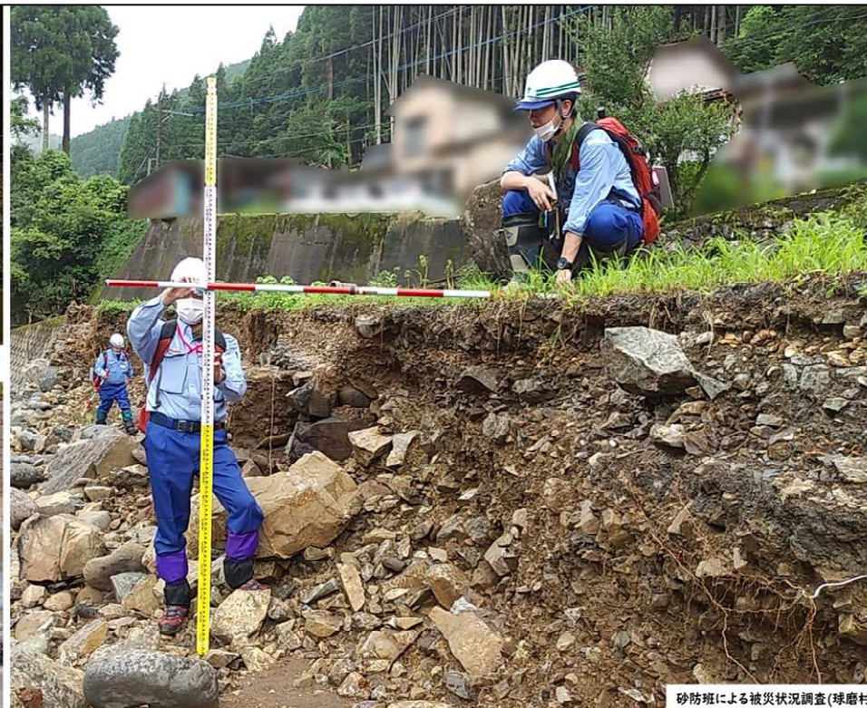
砂防班による被災状況調査(球磨村)
