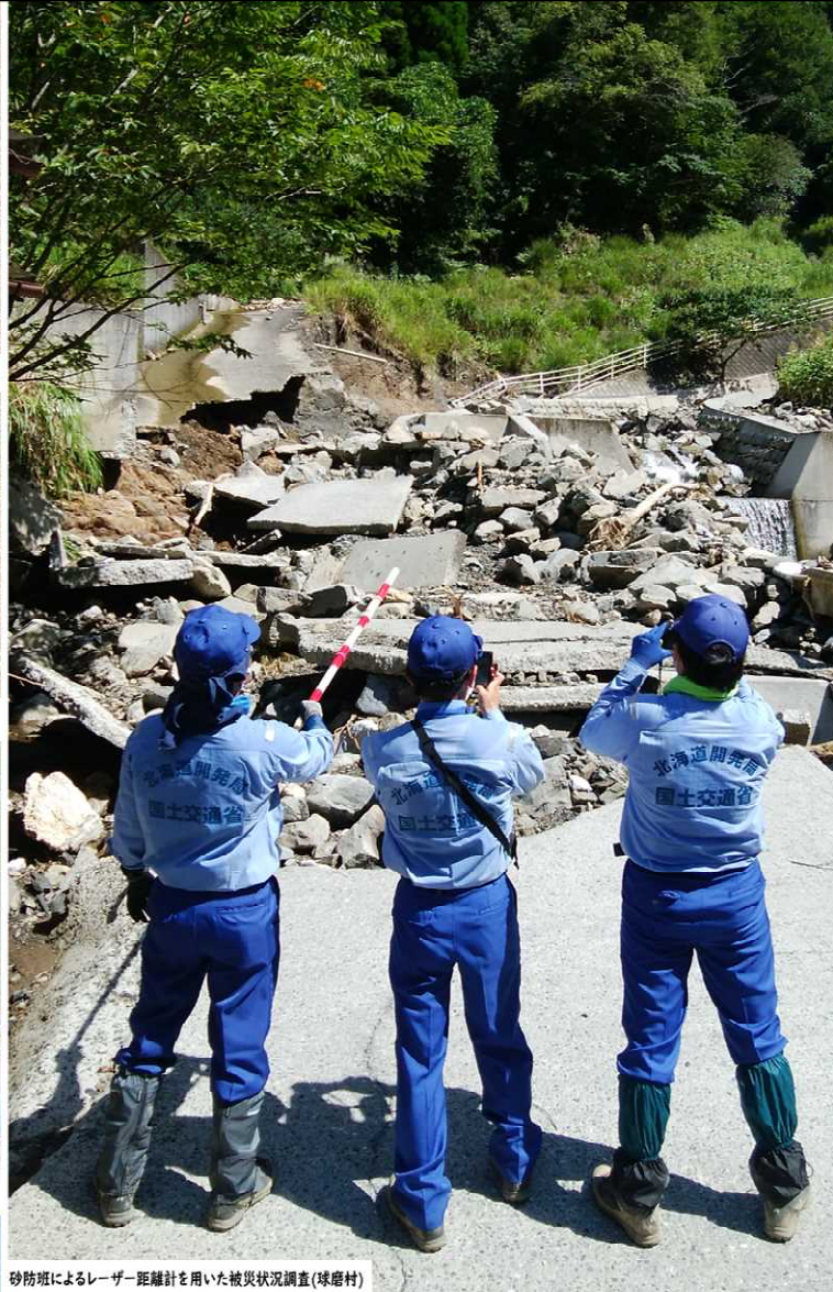
砂防班によるレーザー距離計を用いた被災状況調査(球磨村)
