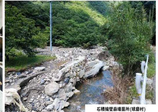
石積擁壁崩壊箇所(球磨村)
