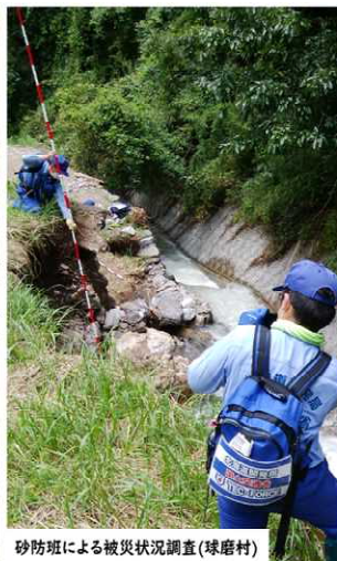
砂防班による被災状況調査(球磨村)
