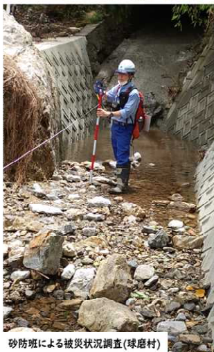
砂防班による被災状況調査(球磨村)
