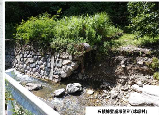
石積擁壁崩壊箇所(球磨村)
