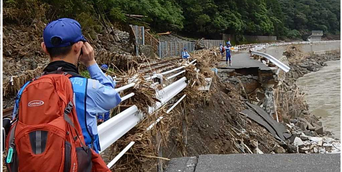
路体崩壊箇所の被災状況調査(県道球磨田浦線)
