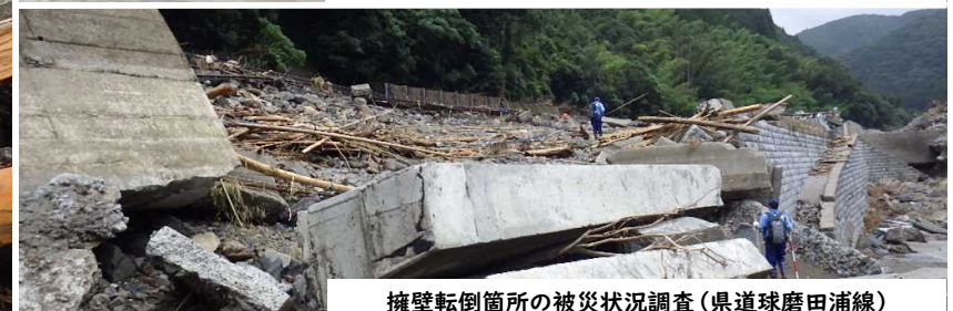
擁壁転倒箇所の被災状況調査(県道球磨田浦線)
