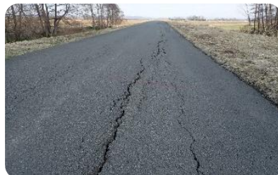
天端舗装の亀裂
