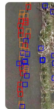
堤防天端の亀裂を自動検知 (AI)
