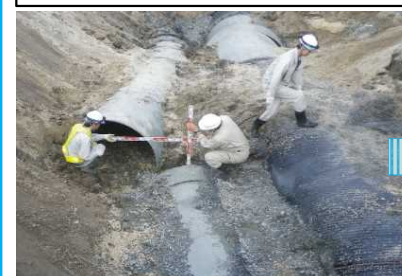
被災した導水路
