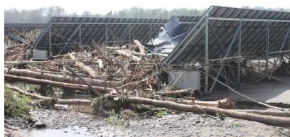
平成28年出水後 流木痕跡状況
