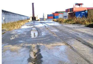
東港区コンテナ埠頭の液状化状況
