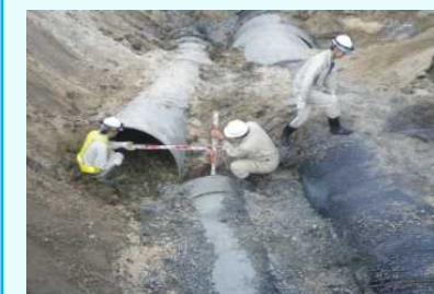
被災した導水路
