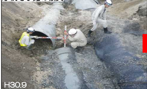
厚幌導水路の被災
