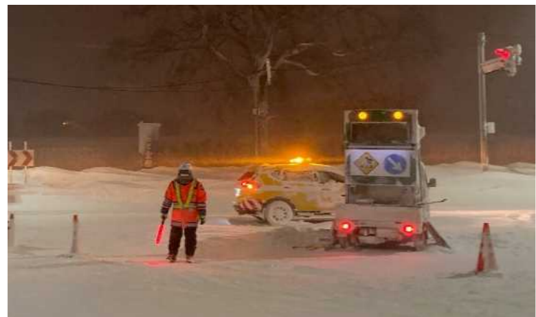
▲ 通行規制の状況 (国道337号 江別市～石狩市) R5.1
