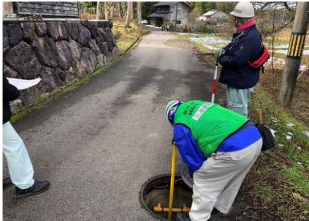
←管路内被災調査①
