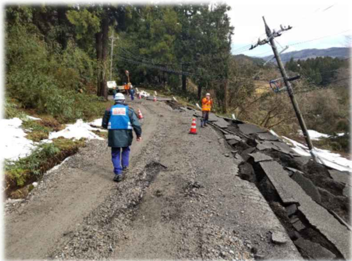
↑ 道路の崩壊と電柱の倒き
