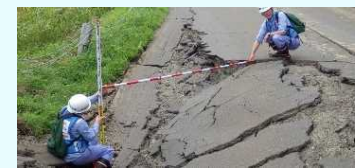
TEC-FORCEによる被災状況調査
