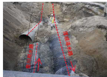
被災した用水路（パイプライン）
