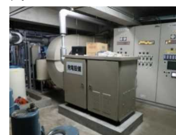
非常用発電設備(イメージ)
