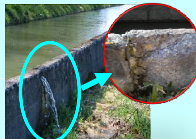
用水路の劣化（漏水の発生）
