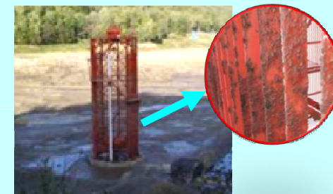
ダム取水施設の劣化
