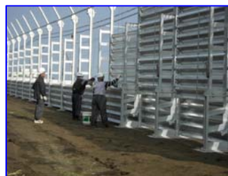
防雪柵の整備
