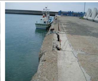
老朽化により危険な状況の岸壁 (庶野漁港)
