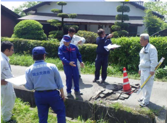
道路損傷箇所への調査（宇城市小川地区）
