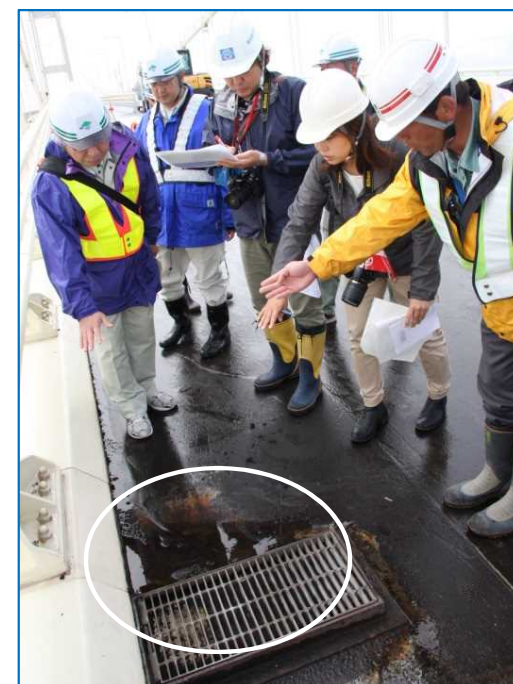
腐食が進む雨水枡のまわり
