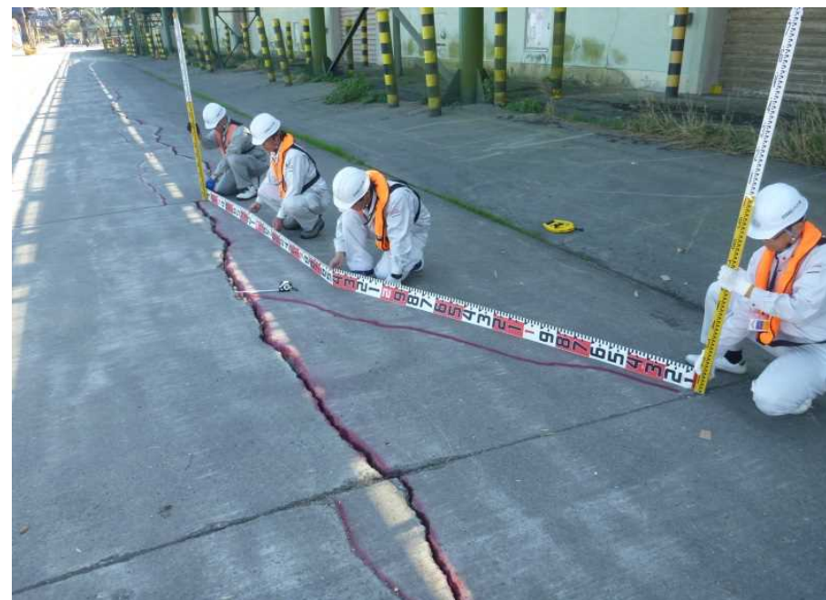
中央南埠頭1号岸壁 エプロンひび割れ
