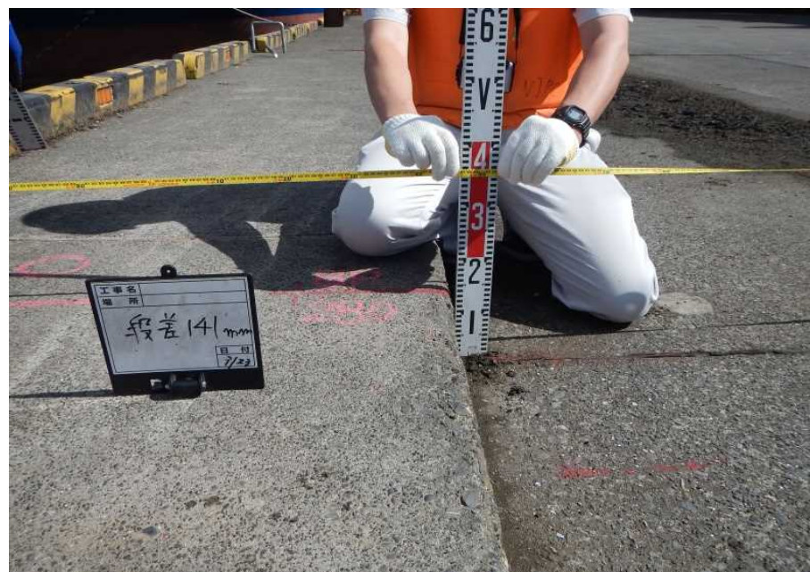
中央南埠頭2号岸壁 エプロン沈下(段差141mm)
