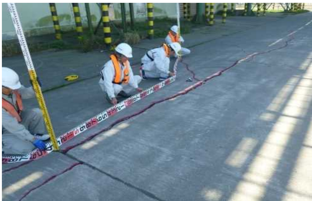
中央南埠頭1号岸壁 エプロンひび割れ
