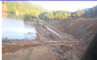
H30年9月6日被災直後の状況
