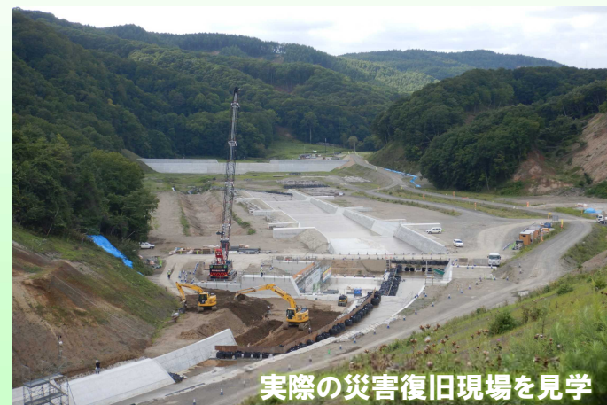
斜面崩壊現場を見学
