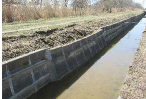
用水路の傾倒が発生 倒壊防止のため維持管理費が増嵩
