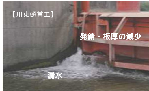
ゲート類の発錆、板厚減少による強度不足 固定堰のひび割れ等
