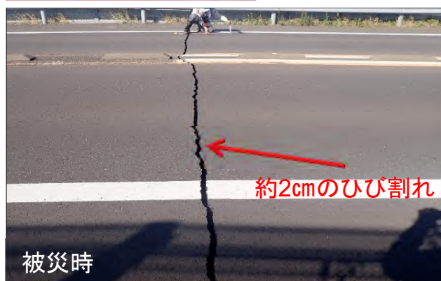
苫東中央IC付近の路面段差
