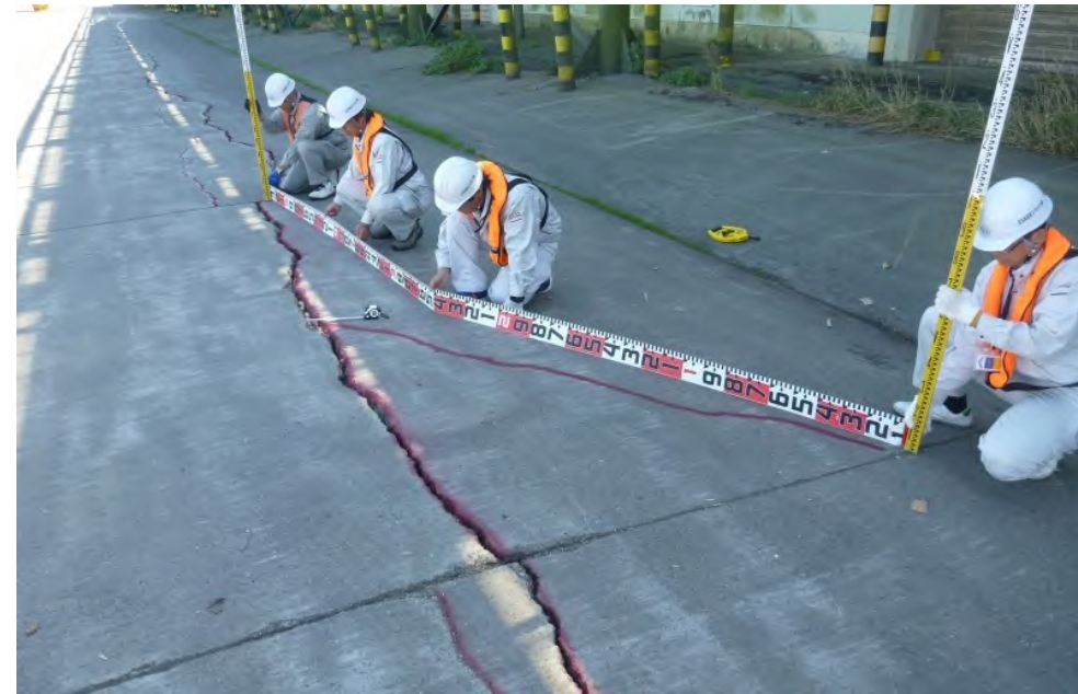
中央南ふ頭1号岸壁 エプロンひび割れ
