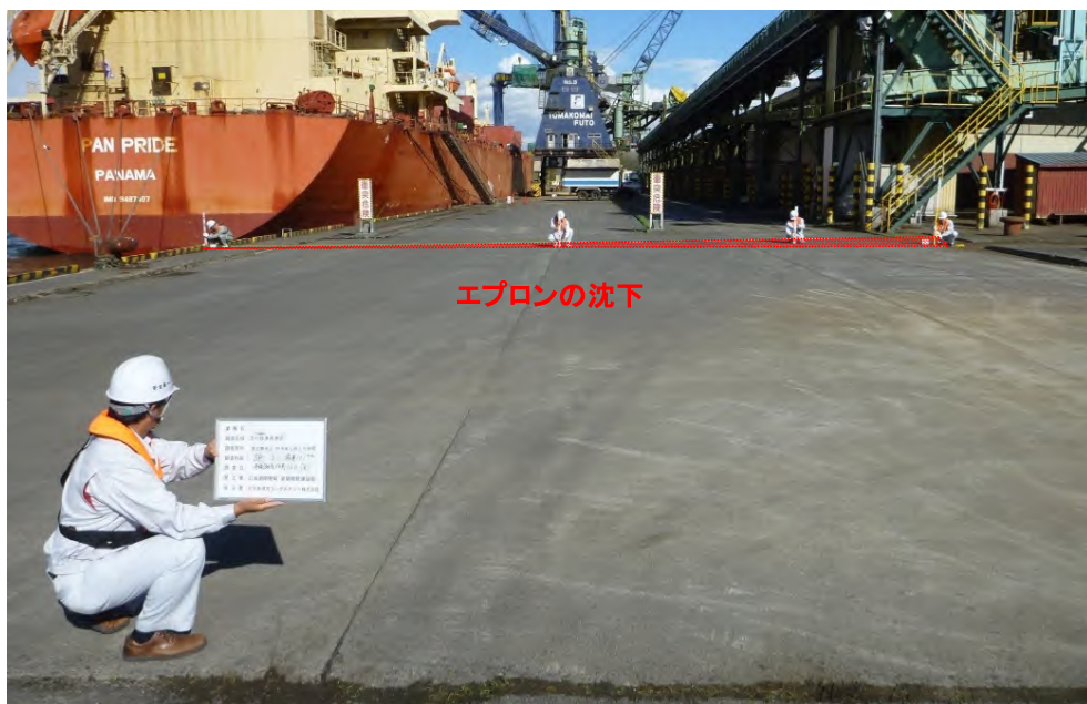
中央南ふ頭2号岸壁 エプロン沈下
