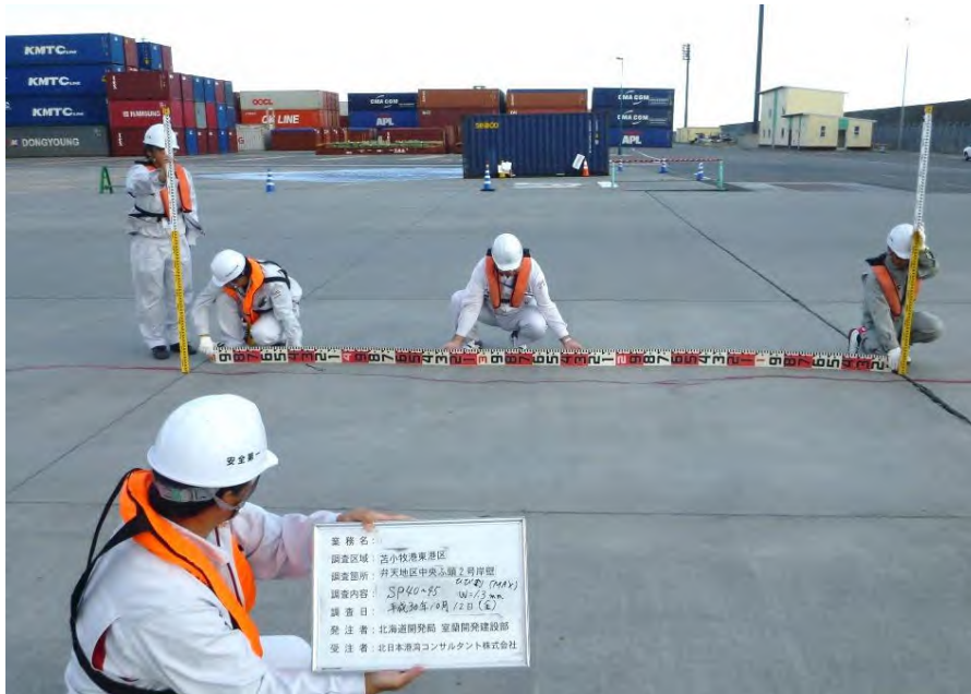
中央ふ頭2号岸壁 エプロンひび割れ
