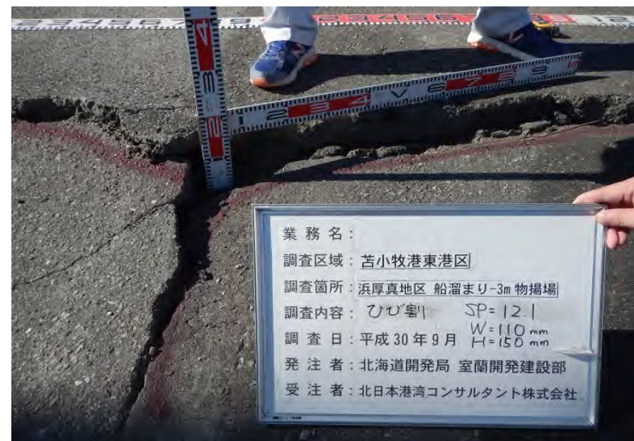
船だまり3m物揚場 エプロンひび割れ
