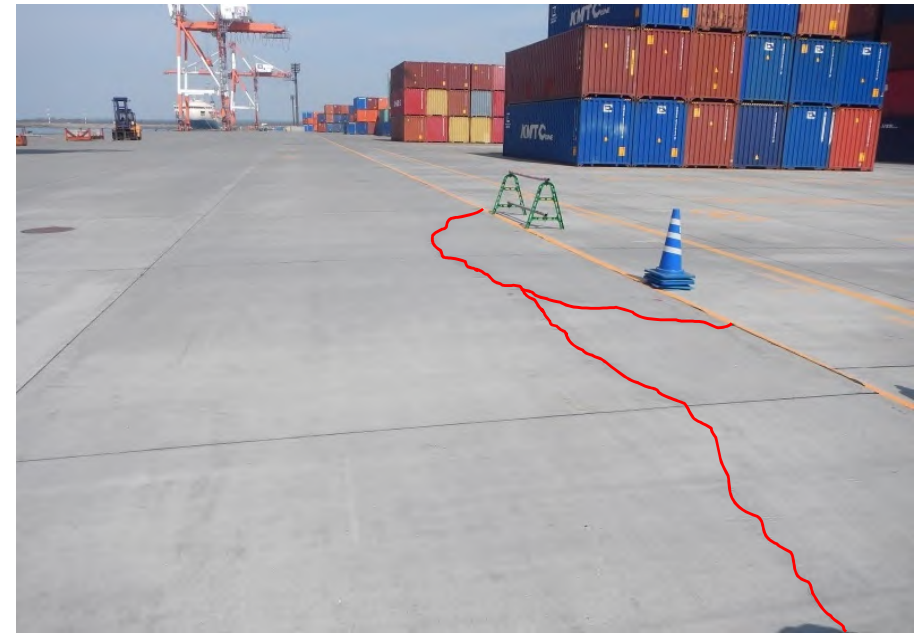
中央ふ頭2号岸壁 エプロンひび割れ
