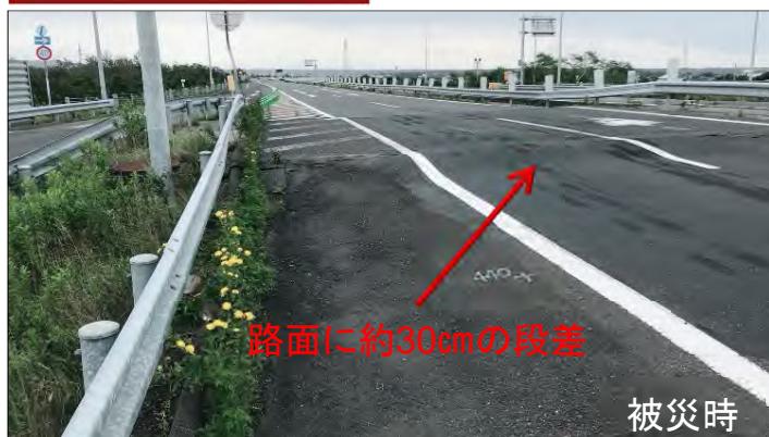
鵜川IC合流部の路面段差
