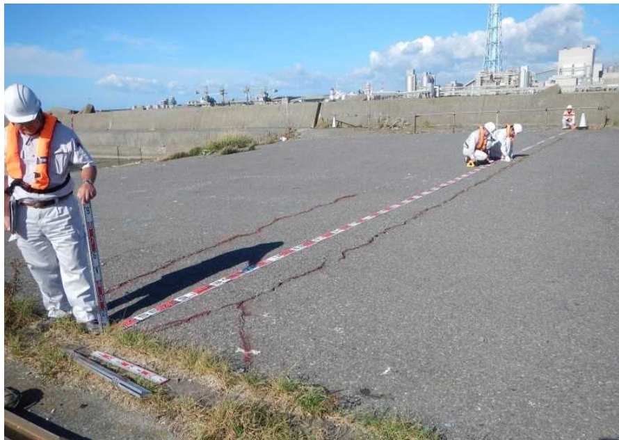
船だまり船揚場 アスファルト舗装ひび割れ
