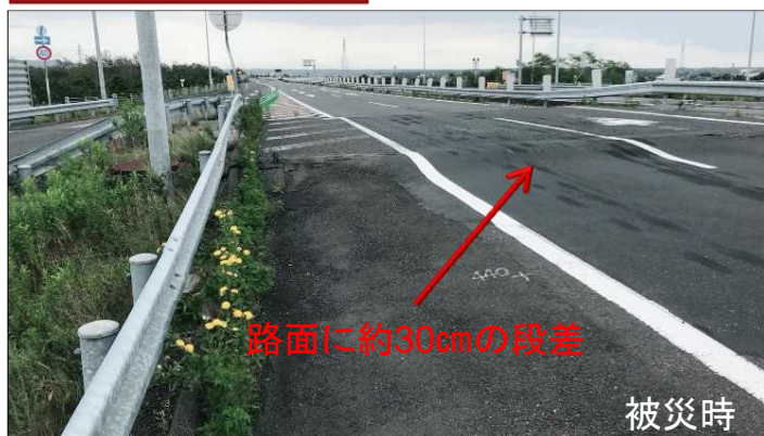
鵠川IC合流部の路面段差
