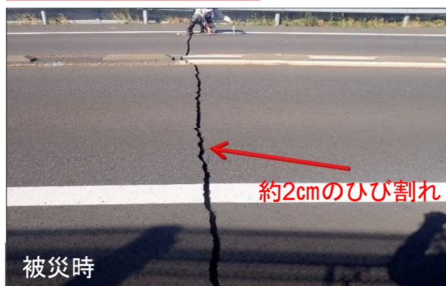
苫東中央IC付近の路面段差
