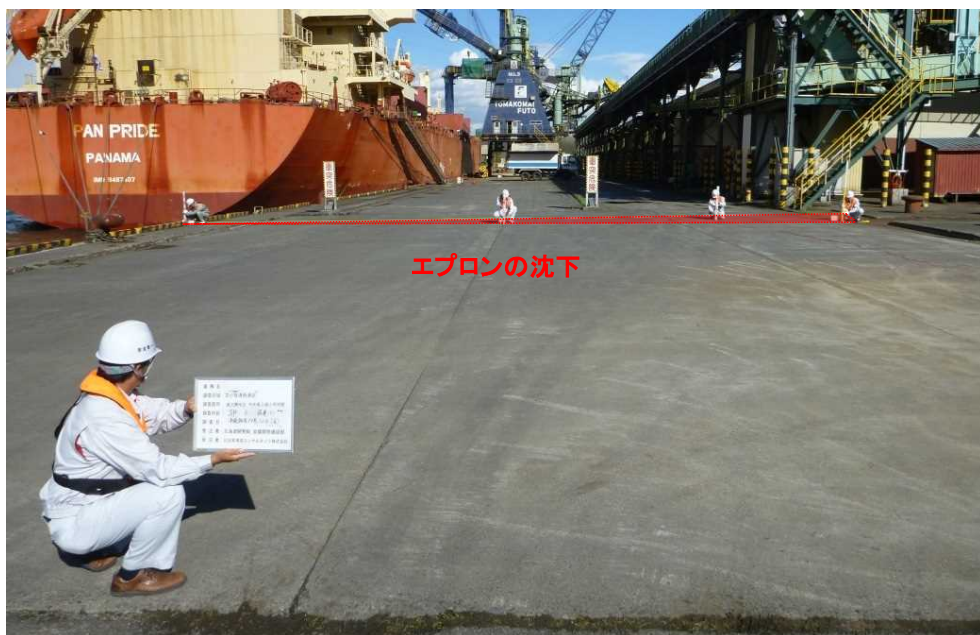
中央南ふ頭2号岸壁 エプロン沈下
