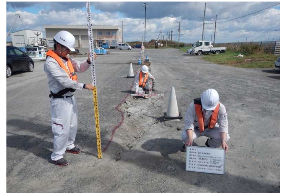
船だまり荷さばき地 起伏、地割れ、沈下
