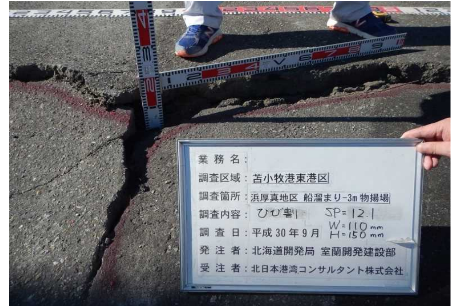
船だまり3m物揚場 エプロンひび割れ
