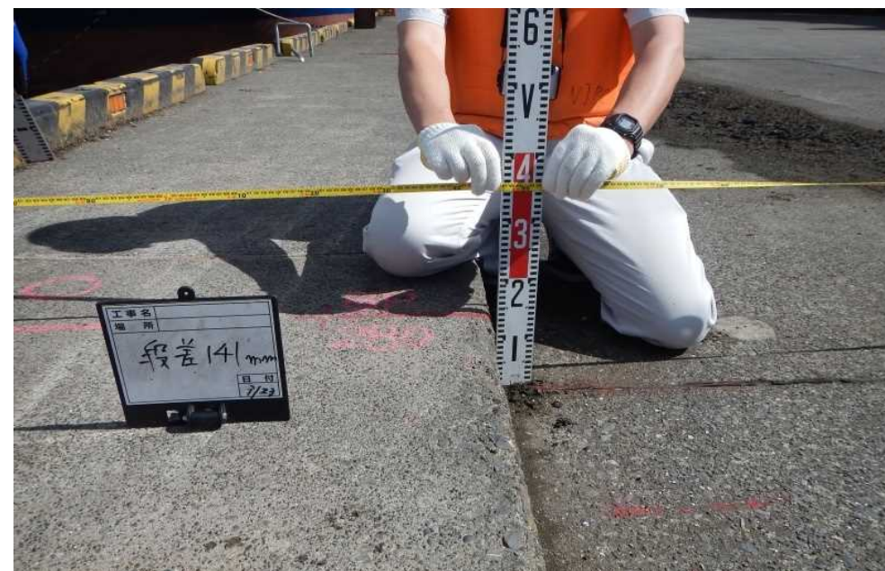
中央南ふ頭2号岸壁 エプロン沈下(段差141mm)
