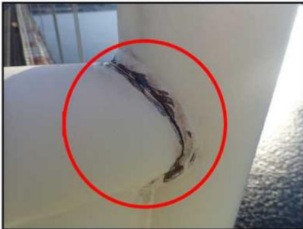
【国道37号 白鳥大橋 道路照明柱部亀裂状況】 (9月30日 12時頃撮影)
